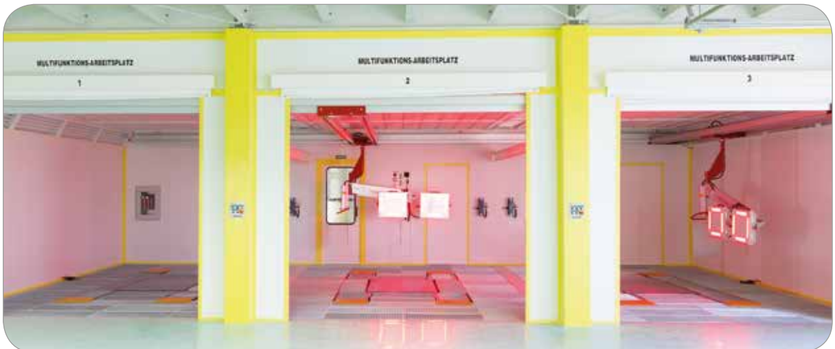
Auto Welt von Rotz AG, CH-9542 Münschwilen: INFRARR IR-Schienensystem und CAV Schleifstaub-Absauganlage
